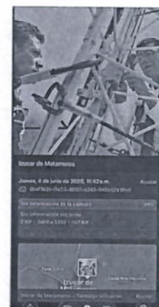
Ilustración 2 Corrección de conectores de camara de videovigilancia
