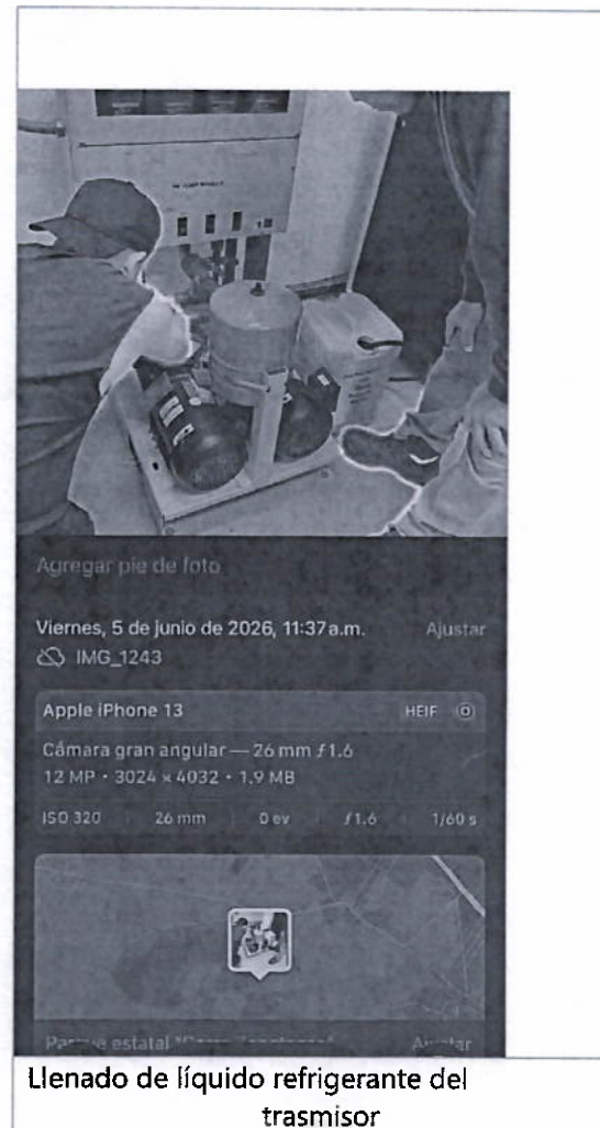
Revisión del nivel de refrigerante del sistema de enfriamiento del transmisor
